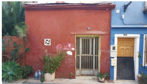
Imagen 3. Estado actual de la fachada a C/ Sant Agustí.
