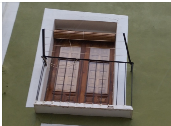
Imagen 7. Barras de tendedero a eliminar en fachada del río
