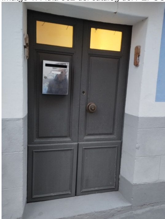
Imatge 2. Porta principal a carrer Álvaro Esquerdo, amb bústia fora d'ordenació
