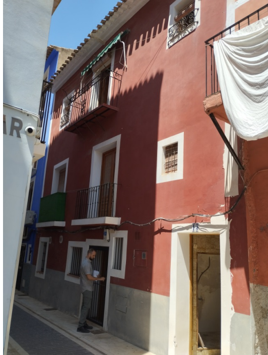
Imagen 8. Fachada a C/ Soletat. Véase la tela de rafia verde en la barandilla de un balcón.
