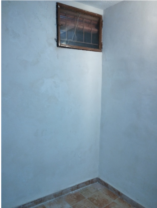
Imatge 7. Finestra a substituir.
