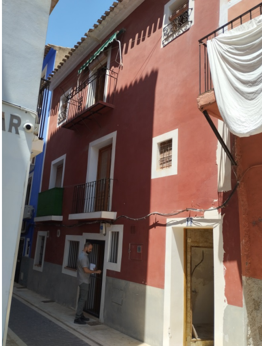
Imatge 8. Façana a C/ Soletat. Vegeu la tela de ràfia verda en la barana d'un balcó.
