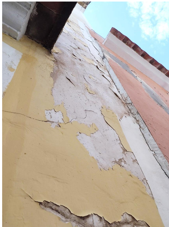
Fig. 4. Paramento de la fachada a calle del Ángel. Véase la pintura moderna sobre el enfoscado antiguo de mortero a la cal.
