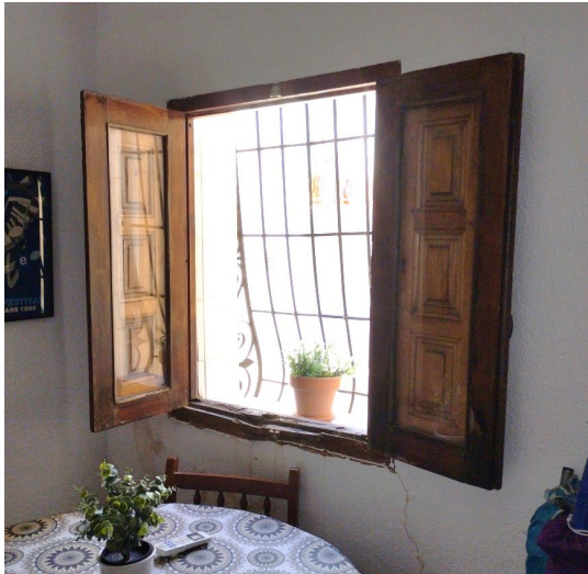
Fig. 6. Finestra a substituir.
