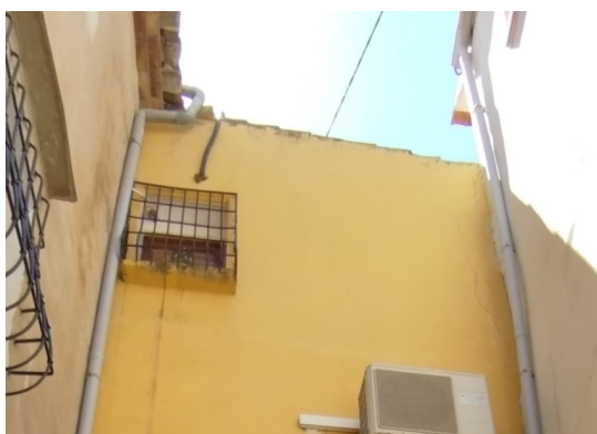
Fig. 5. Grieta en parte superior de fachada de carreró del Pal, y vista exterior de la ventana a sustituir.
