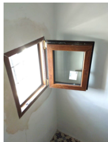
Fig. 2. Carpintería de ventana de la escalera, a corregir el acabado.
