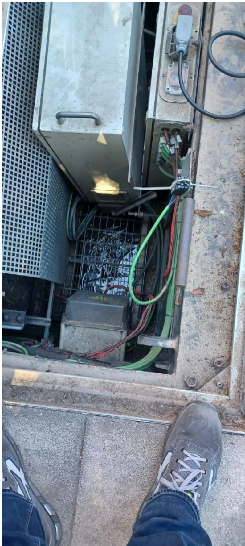
RAMPA MECÁNICA NÚM. 3 / RAMPA MECÁNICA N°3
