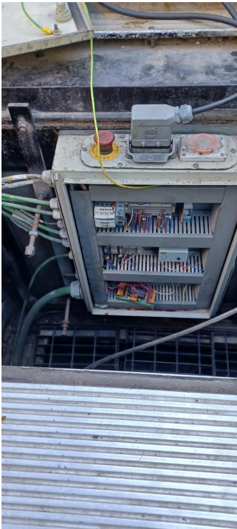
RAMPA MECÀNICA NÚM. 4 / RAMPA MECÁNICA Nº4
