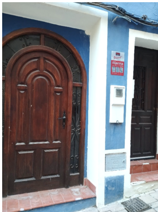
Fig. 1. Puertas de acceso desde C/ Fray Posidonio. La izquierda es impropia, a sustituir. La derecha es antigua, a conservar.
