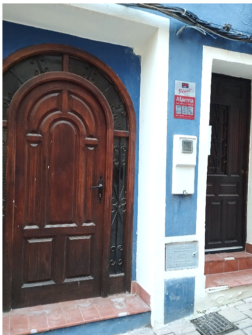
Fig. 1. Portes d'accés des de C/ Fra Posidonio. L'esquerra és impròpia, a substituir. La dreta és antiga, a conservar.
